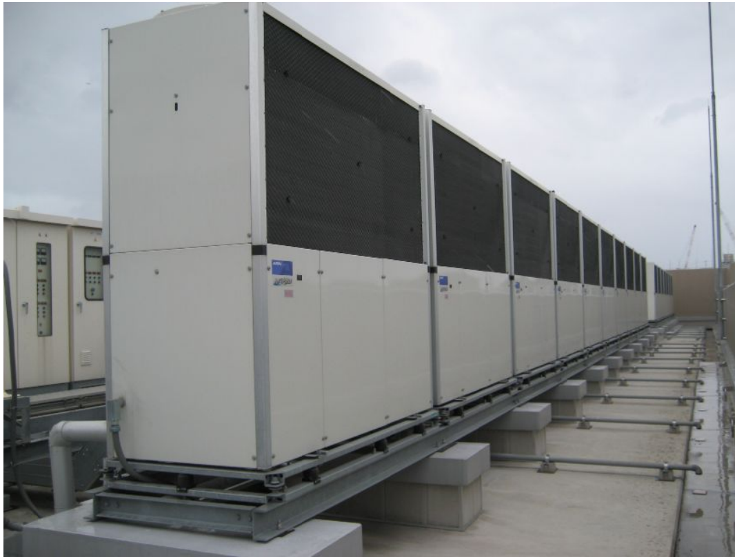
ガスエンジンヒートポンプ室外機 （B3棟屋上）
