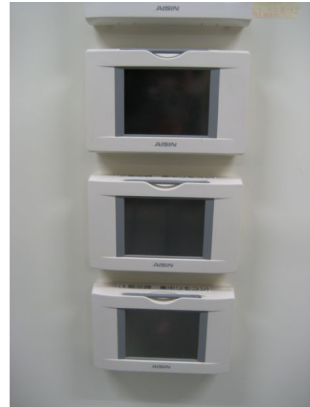
集中コントローラ （B3棟管理室）
